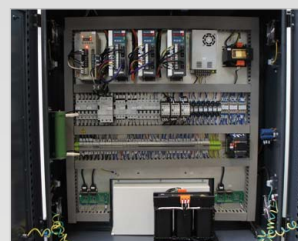
Dobře přístupný rozvaděč
