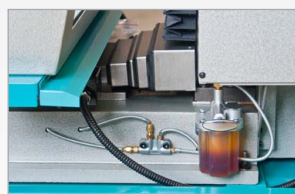
Centrální rozvod mazání
