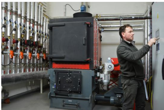
Automatická kotelna na dřevní biomasu 2014
